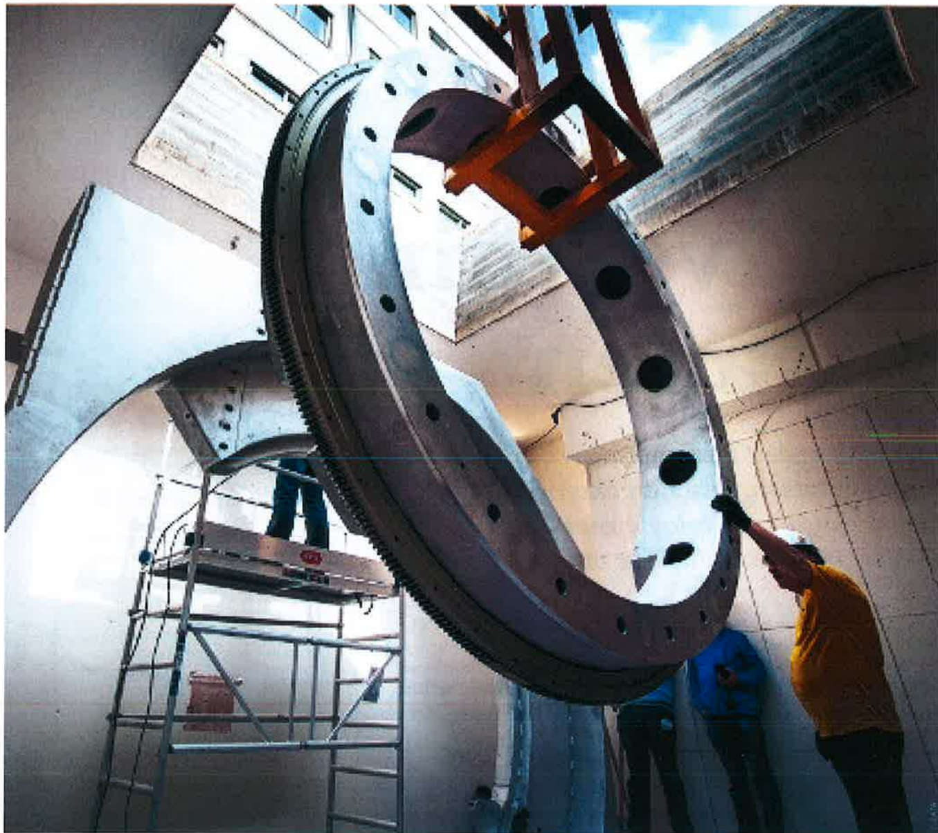
Installatie van de MRI-linac in het UMC Utrecht.
